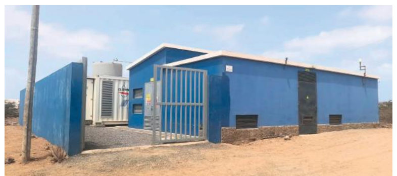
Sistema de armazenamento de energia eléctrica em baterias na ilha do Sal
