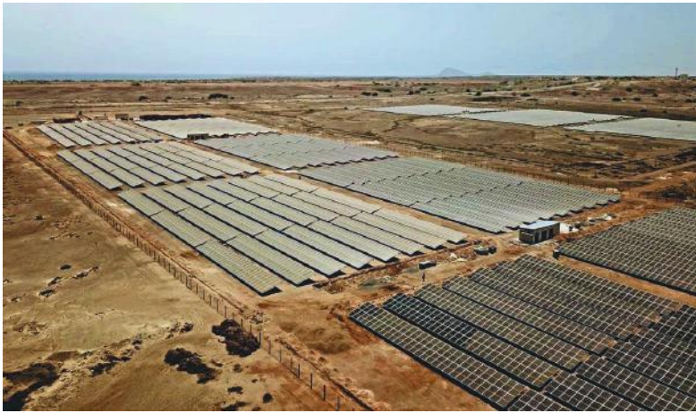
Central fotovoltaica 5mw, em Santa Maria, Ilha do Sal
